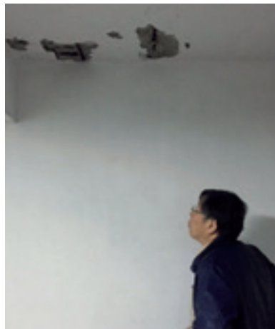
市長柯文哲視察海砂屋國宅，現場天花板剝落情形嚴重，亟需修建。
