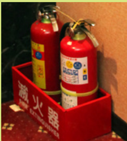
旅客入住旅館後應了解滅火器及逃生等設備、設施與位置。（王能佑攝）
